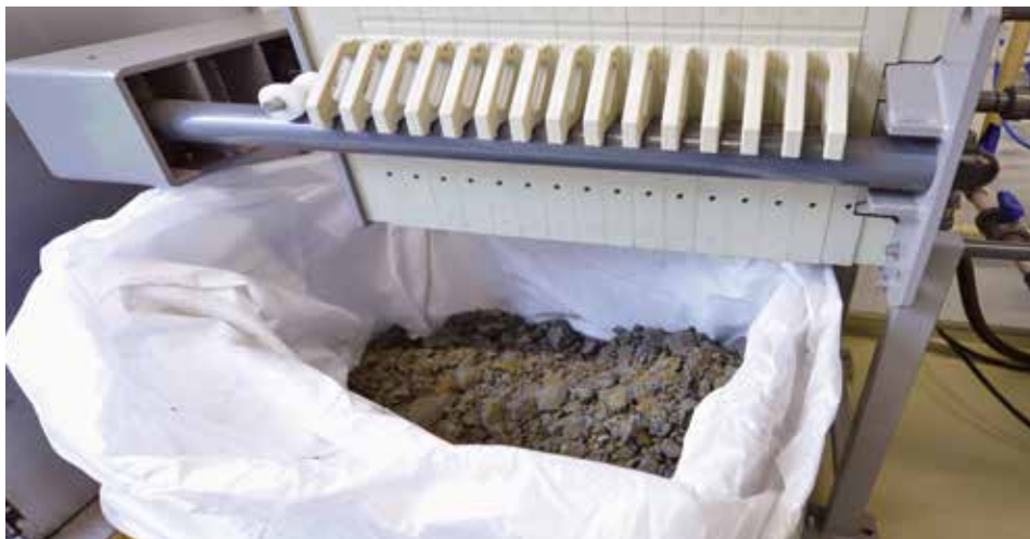
Filtre presse avec bac de récupération des boues déshydratées.
